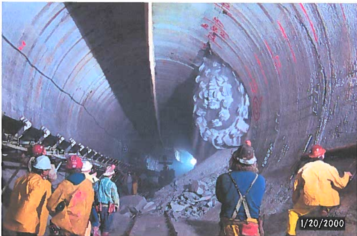
Joonis 5. Täisprofiilmasin (Robbins TBM) freesib tunnelit USA-s Chicagos. Pildil näha olevad puurimisseadme lõikepead on avanud ühenduse peatunnelisse, mis on samuti tehtud TBM-meetodi abil. Allikas: Lach jt. 2000
